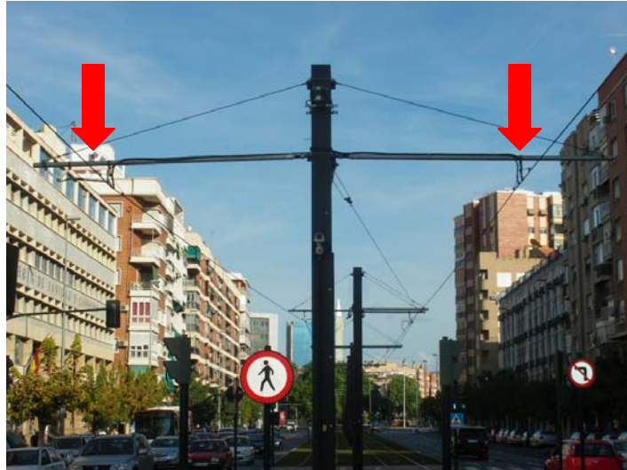
Figura 2. Línea de alimentación (catenaria) de un tranvía.
