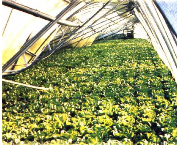
Figura 13-b. Daños en un invernadero túnel por la nieve (Sur de Francia)
