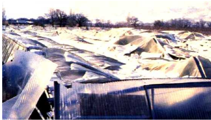
Figura 13c. Daños en invernadero multinave por la nieve (Sur de Francia)
