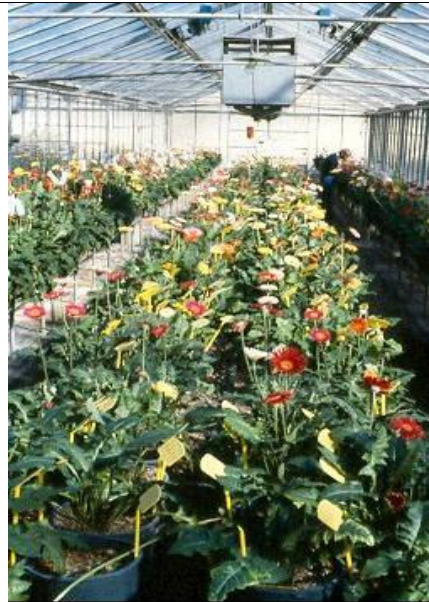
Figura 4. Vista de la ubicación de un aerotermo en invernadero.
