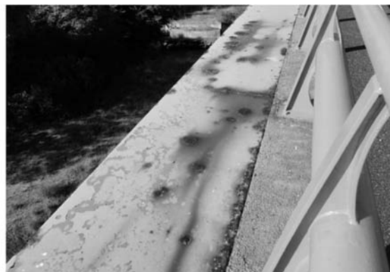
Corrosión severa con picaduras debido a la utilización y acumulación de sales de deshielo
