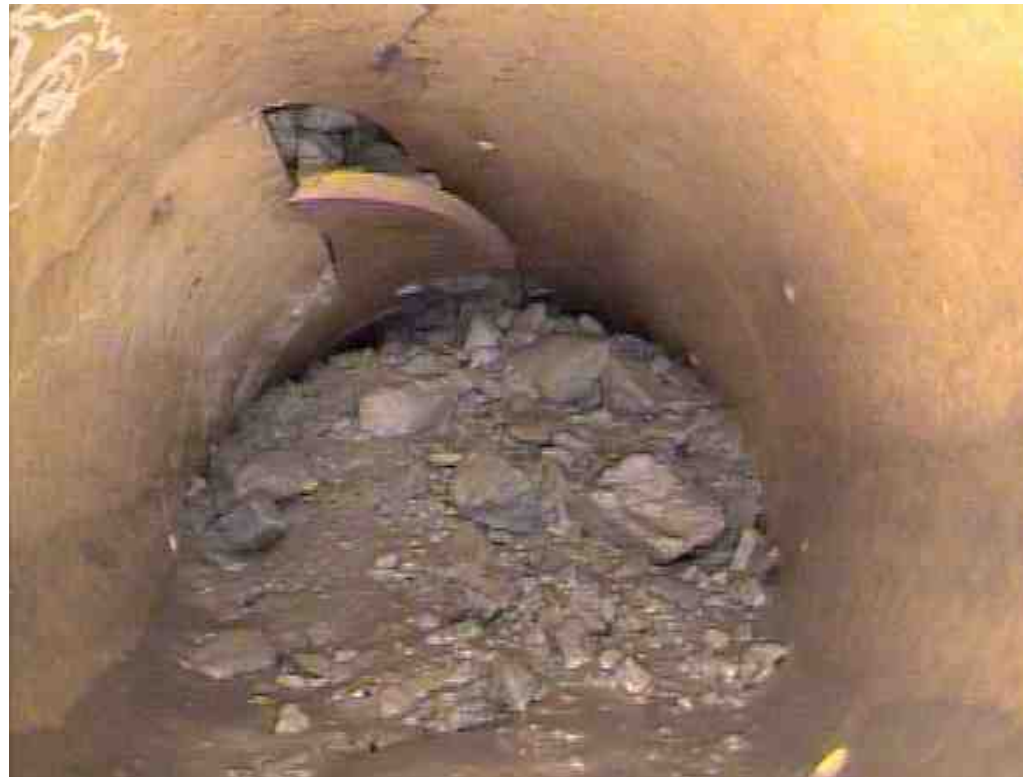
Rotura de una tubería de PVC por efecto de cargas externas
