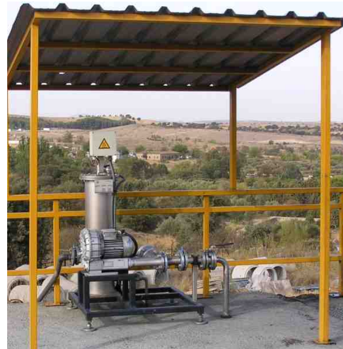
Eliminador de ozono residual sobre las cámaras de ozonización
