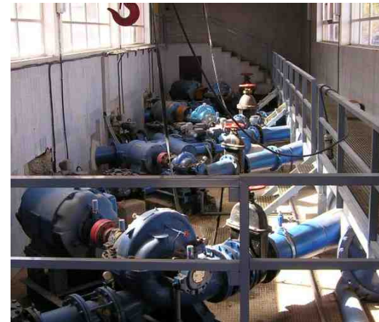
Estación de bombeo de agua bruta hacia la ETAP
