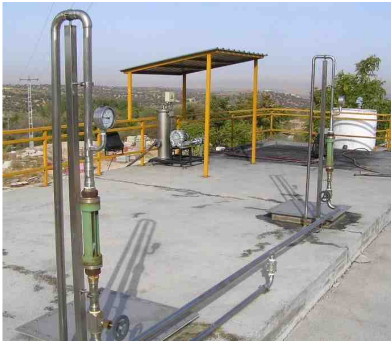
Conductos de ozono hacia las cámaras de preoxidación
