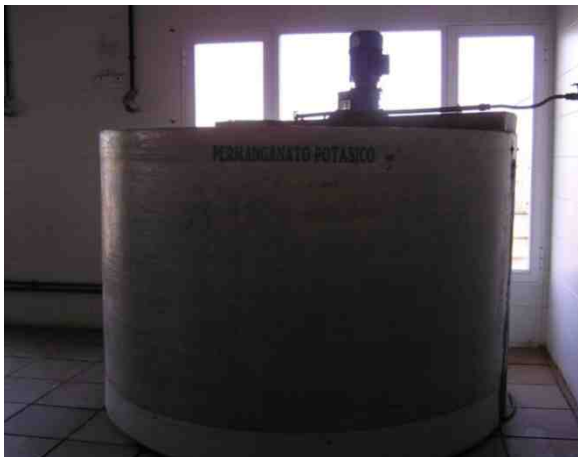
Depósito de mezcla y dosificación de permanganato fuera de servicio
