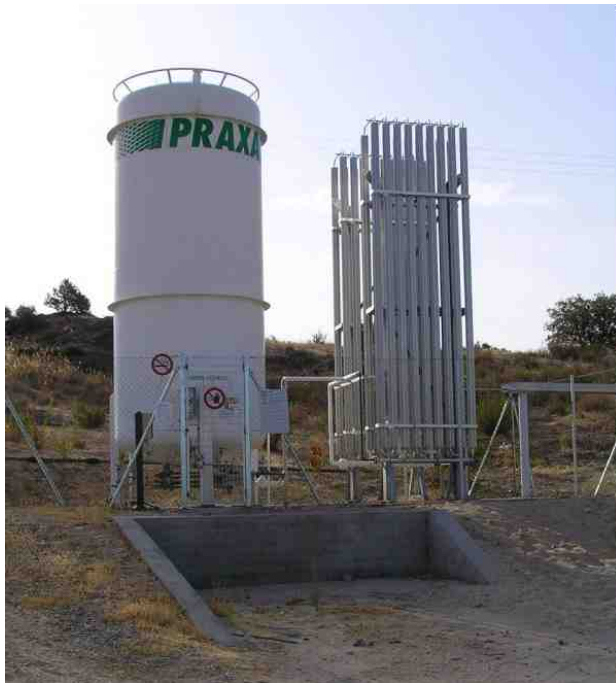
Almacenamiento de oxígeno líquido para generación de ozono
