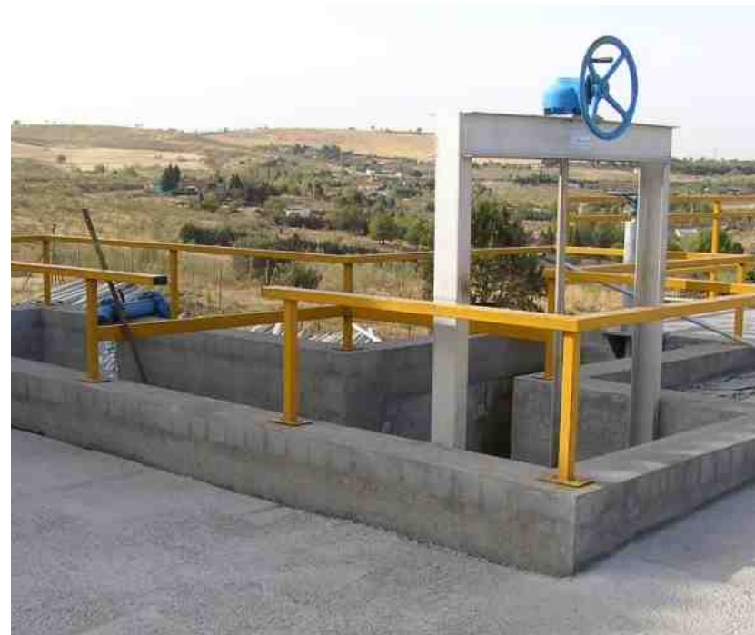
Compuerta tajadera para aislamiento del pretratamiento
