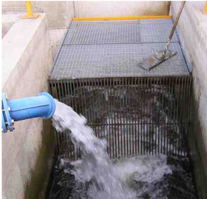
Canal de entrada en la ETAP con rejilla de desbaste manual
