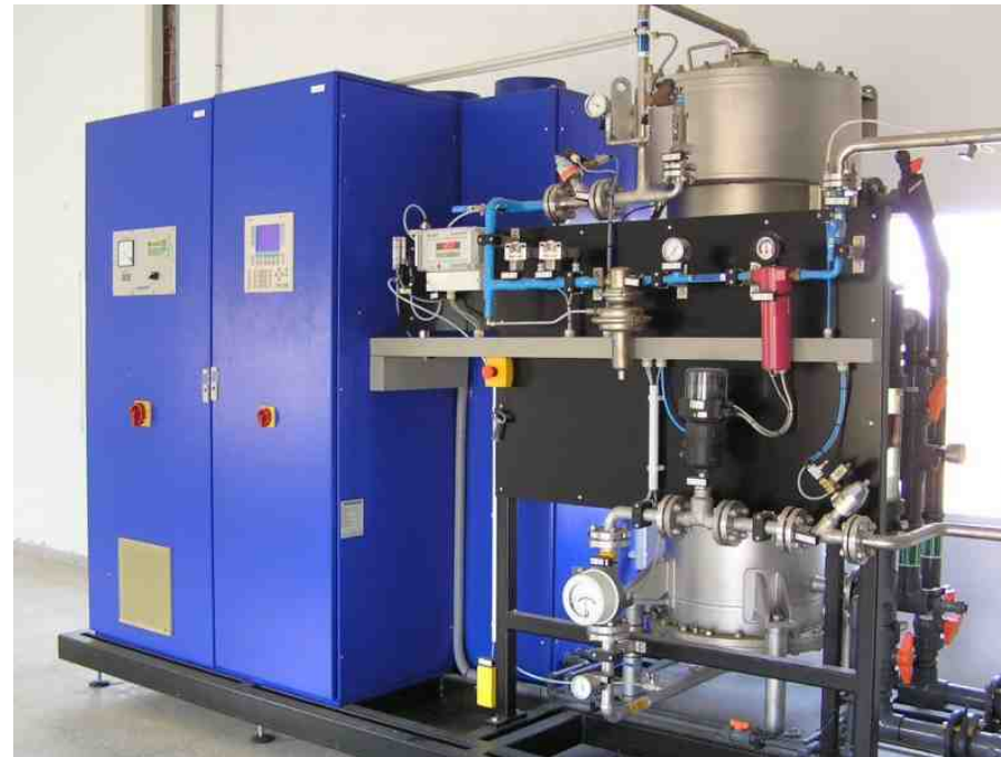
Generador de ozono para preoxidación del agua bruta
