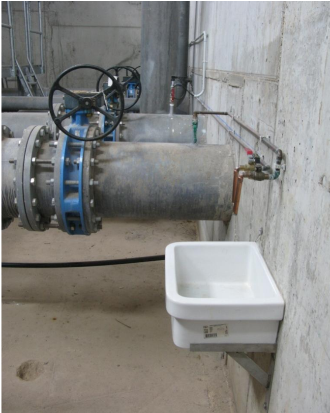
Instalación para toma de muestras (depósito de Águilas, Murcia)
